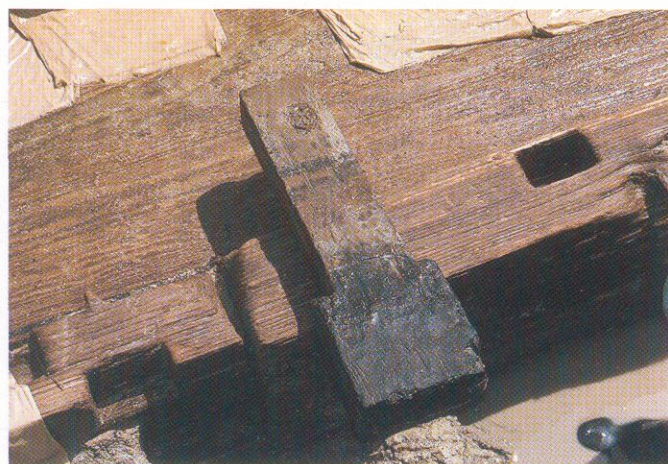
抜き取られた大栓
