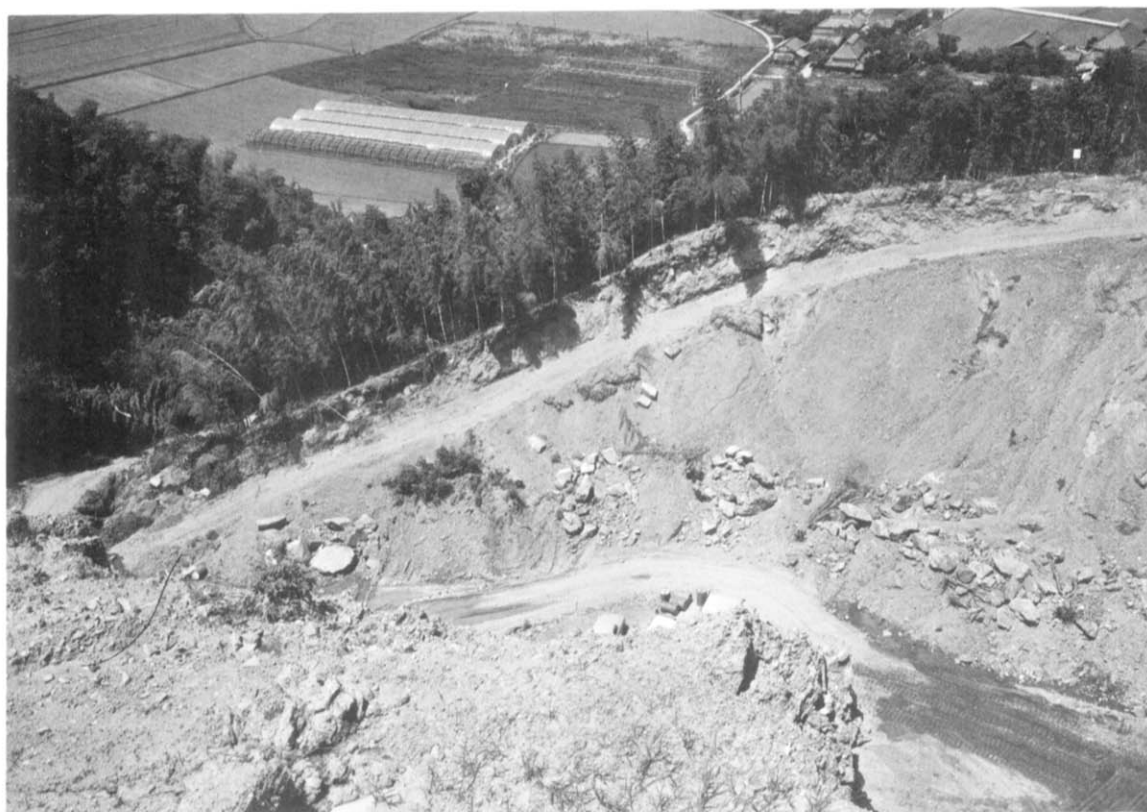
第3次調査地点産女谷水門付近の破壊状況
