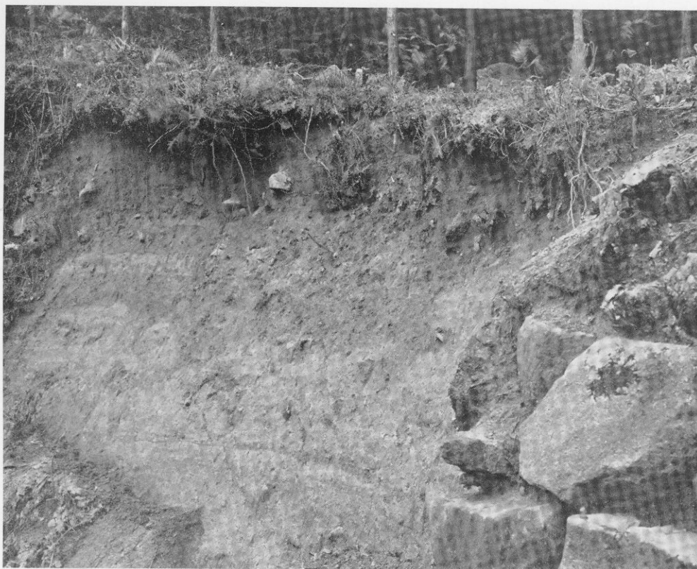
S A074—W 裏込めの版築（崩壊面）
